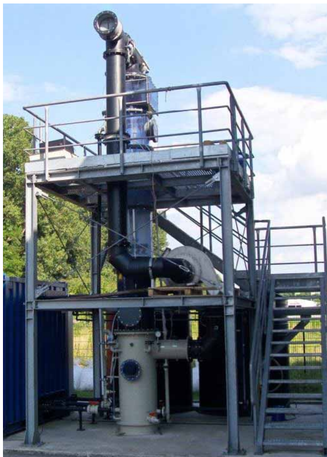
Anlage für Referenzmessungen im technischen Maßstab (600 mm) bei der Fa. ENVIMAC
